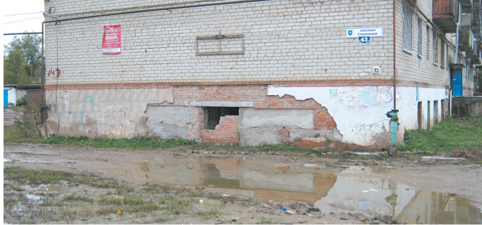
Одна из стен дома №43 пр.Строителей
